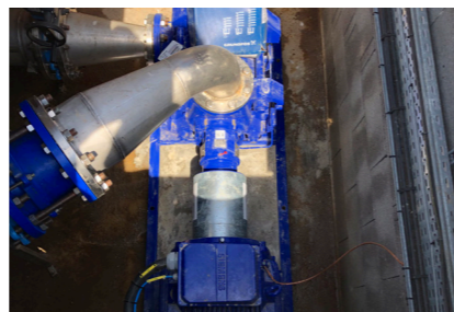
Microcentrale hydroélectrique au Réservoir du Chancet.
