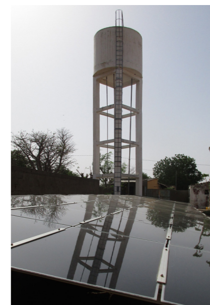
Le pompage solaire.
