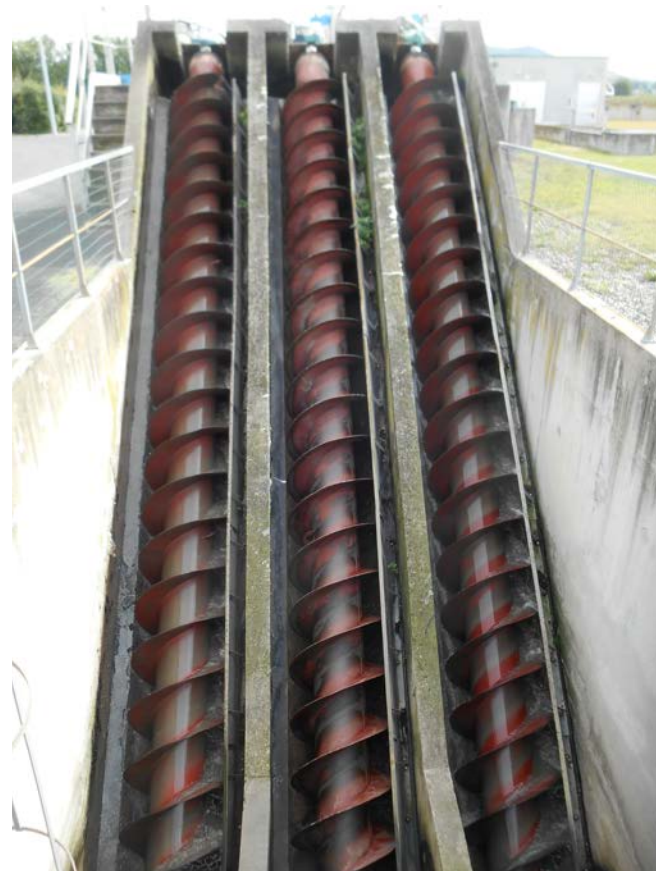
Vis d'archimède de la station des Madeleines à Pont-du-Château
