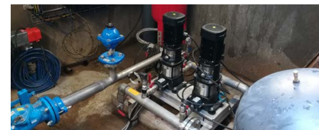
Surpresseur de Rochepradière à Saint-Hyppolyte.
