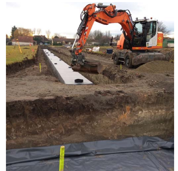
Bassin de rétention d'eaux pluviales, lotissement Le Verger fleuri 2 à Saint-Laure.
